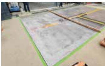
Se aplica una capa de EA Primer sobre el área de reparación.
