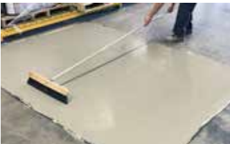
Se hace un acabado antideslizante con una escoba después de la segunda capa de Surface Armor™.
